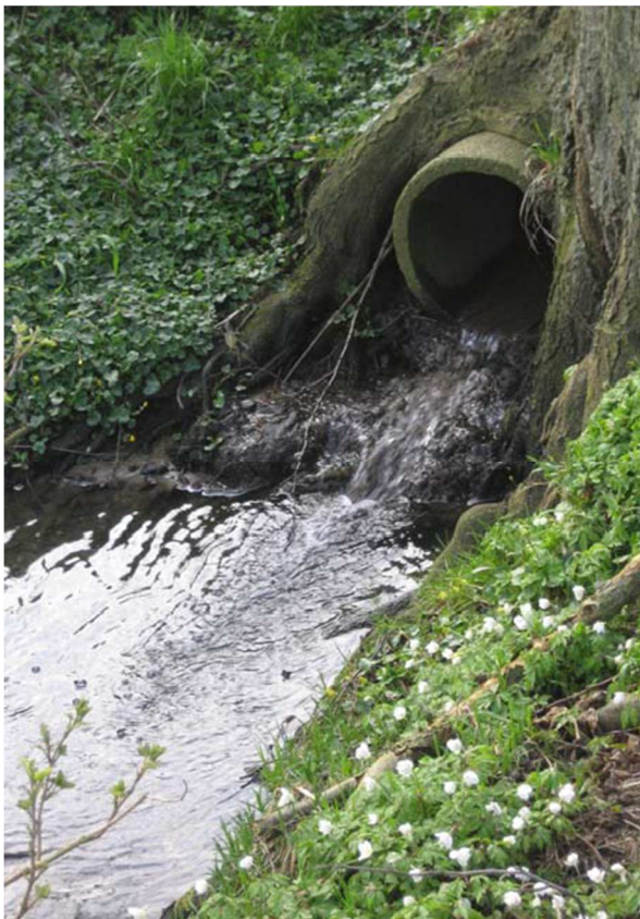
Kloakudløb i vandløb ved Laksevej i Langå.
